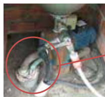
Detalle de mala práctica no selado da boca do pozo
